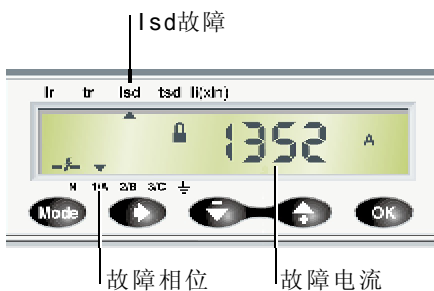
显示故障电流
